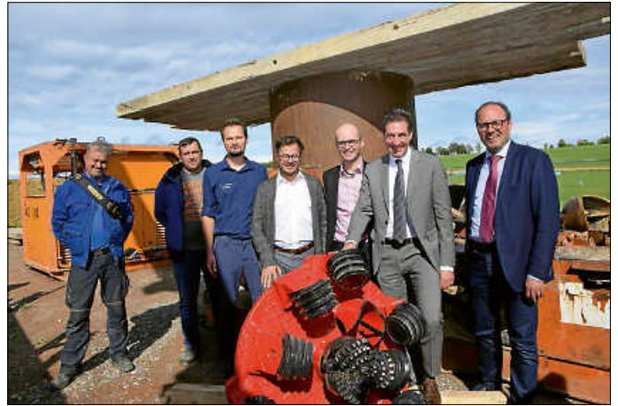
Zufriedene Gesichter beim Baubeginn des Förderbrunnens der Donaueschinger Trinkwasser-Ersatzversorgung von links: Oliver Krohn und Michael Pohl (Baufirma Abt Wasser- und Umwelttechnik GmbH), Kai Baudis, (Betriebsleiter Eigenbetrieb Wasserversorgung), Gerd Schill (Fritz Planung GmbH), Georg Zoller (Kaufmännischer Leiter Eigenbetrieb Wasserversorgung), Oberbürgermeister Erik Pauly und Bürgermeister Severin Graf.
