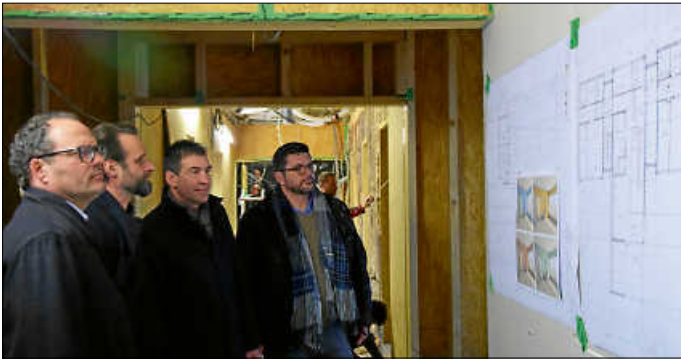
Bauleiter Norman Gartner, Architektenbüro Alexander Schmid, (2. v. Links) erläutert Bürgermeister Severin Graf, Oberbürgermeister Erik Pauly und, Niko Reith, Aufsichtsratsmitglied KEG, die Baupläne
